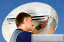
Instalação e Manutenção de Ar-Condicionado
